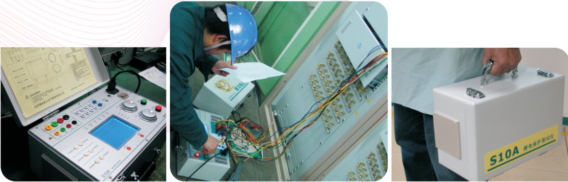
S10A继电保护测试仪现场测试
